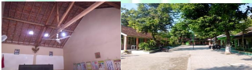
Gambar 4.2 : Kondisi Plafon Kelas dan Paving Halaman SDN Grobogan 2
